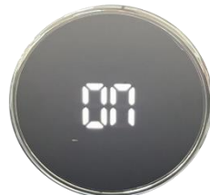
咖啡锅炉补水开关
