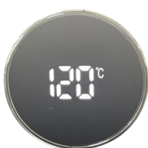
蒸汽锅炉温度
